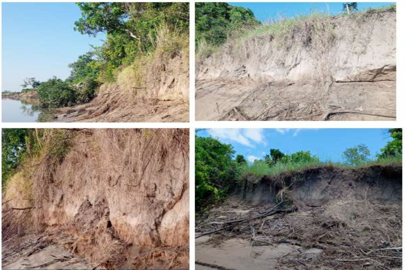
Figura 128. Situação de erosão no local de estudo_1º de Maio
