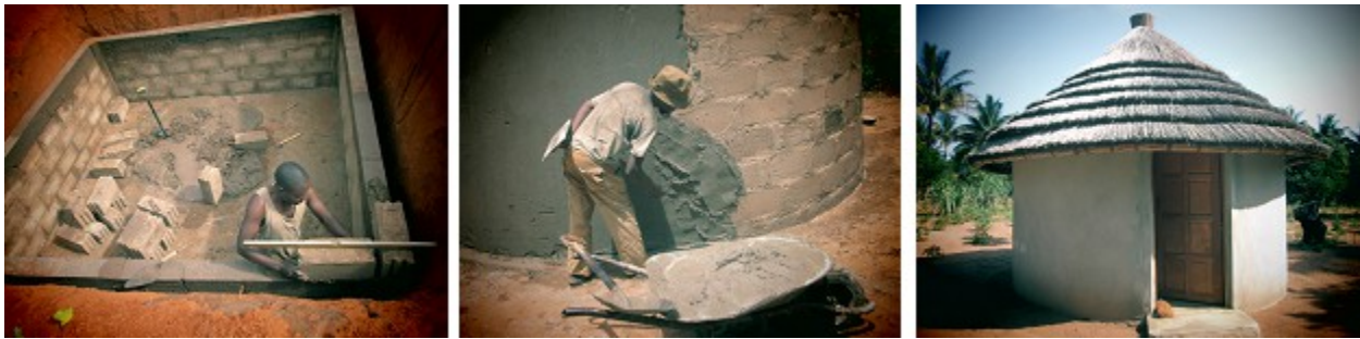
Figura 7 – Construção em curso de um tanque de captação de água, uma palhota híbrida e uma já concluída
