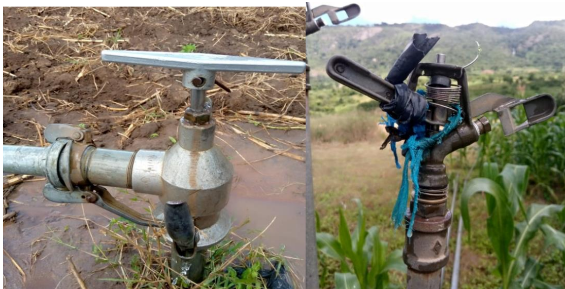
Figura 7.2: Hidrante e um dos aspersores no sistema de distribuição
