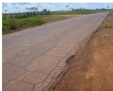
Trincas em blocos
