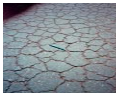
Trincas de jacaré
