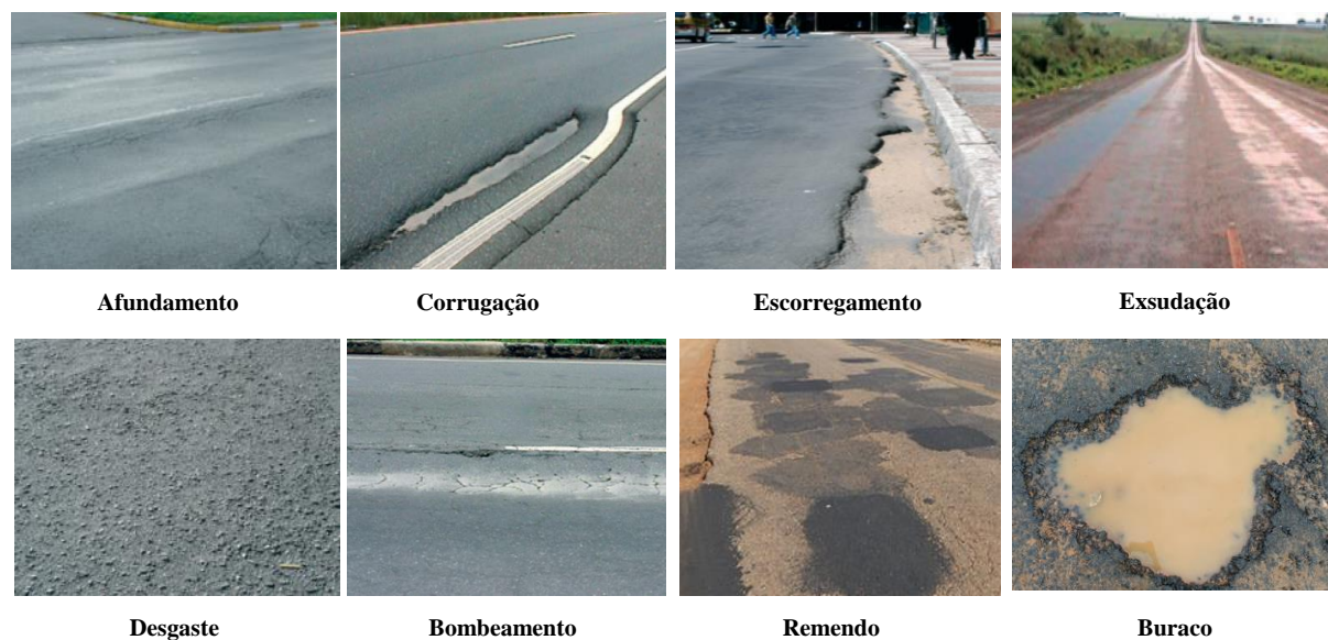
Figura 5. Defeitos do pavimento asfáltico. Fontes: (Autora; Bernucci et al. , 2008; Singh e Kumar, 2021; Walker, 2013).
